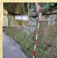
積石の凹凸やせり出し、擁壁の影ろみが認められる。
