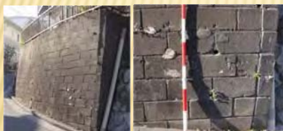
擁壁表面がふくらんでおり、積石が浮きだしている部分が認められる。
