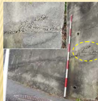
ジャンカの認められるコンクリート擁壁。
