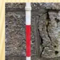
摩耗・劣化が進み、クラックが認められる大谷石積み擁壁
