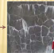
アルカリ骨材反応により亀甲状のクラックが発生。さらに、クラック幅は大きい場合は危険である。
