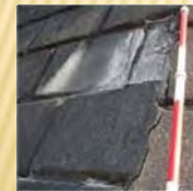
さらに合わせ目の破損や表面の剥離等も目立つようになる。
