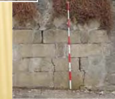
開口クラックや積石のふくらみなどの変状が顕著で危険な状態にある擁壁
