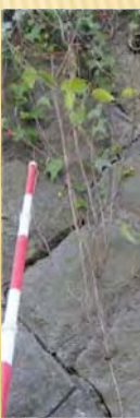
擁壁が縦・斜めクラックを境に上下にずれている。
