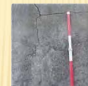
擁壁に不規則なクラックが見られる。
