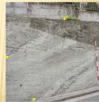
コールドジョイントの認められるコンクリート擁壁。
