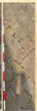
積み石に沿った縦・斜めクラックの幅が大きく、縦・斜めクラックがある。
