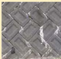
積石の敷置所から白色生成物が折出しており、その高さが一定である。
