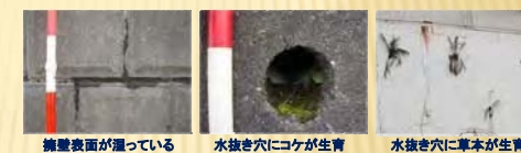
擁壁表面が湿っている
