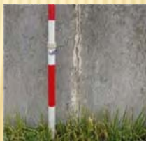
擁壁の目地から折出した白色生成物
