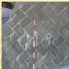
クラックからの白色生成物が多く見られる擁壁
