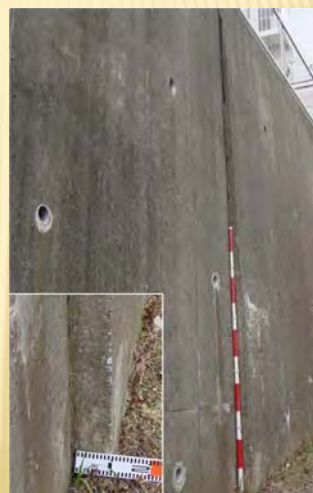
10cm程度の大規模な水平移動が認められるコンクリート擁壁
