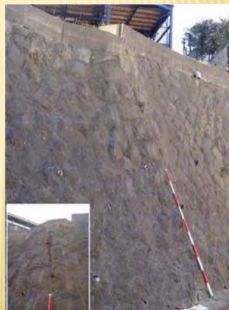
目地の部分がふくらんでいる練石積み擁壁。
