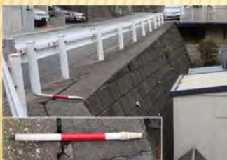
1.5cm程度の水平移動が認められる擁壁
