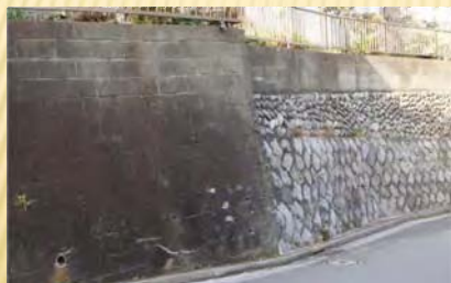
写真左側の間知ブロック積み擁壁は明らかに後傾しており、写真右側の練石積み擁壁は、やや後傾している事例。
