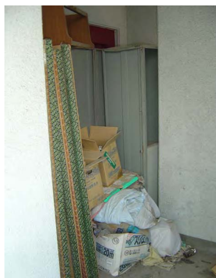
各階のEVホール部分がゴミや不要物の置き場になっている
