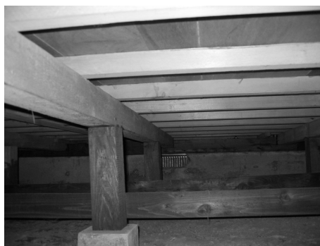
図 15.5.7 防蟻処理が施された束、根絡み
