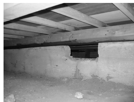
図 15.5.8 防蟻処理の際に作られた通気口
