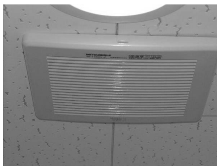
省エネ住戸（高効率モーター：消費電力8.4W）
