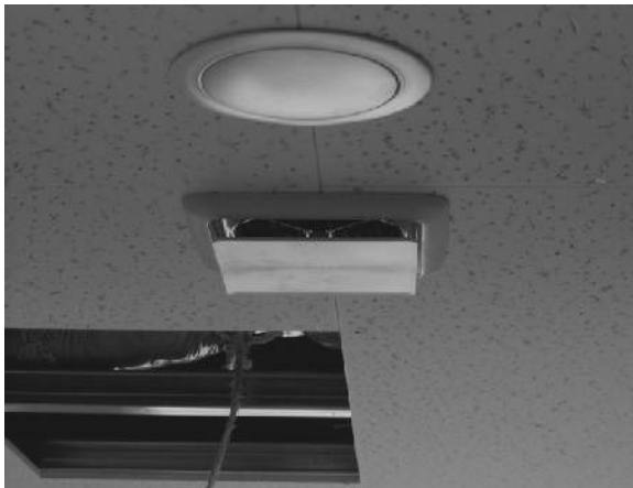
平成14年10月17日 ハイブリッド換気 子供室給排気口
