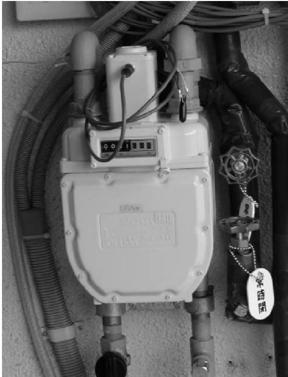
平成14年11月15日 パルス発信機付きガスメータ(303号室)
