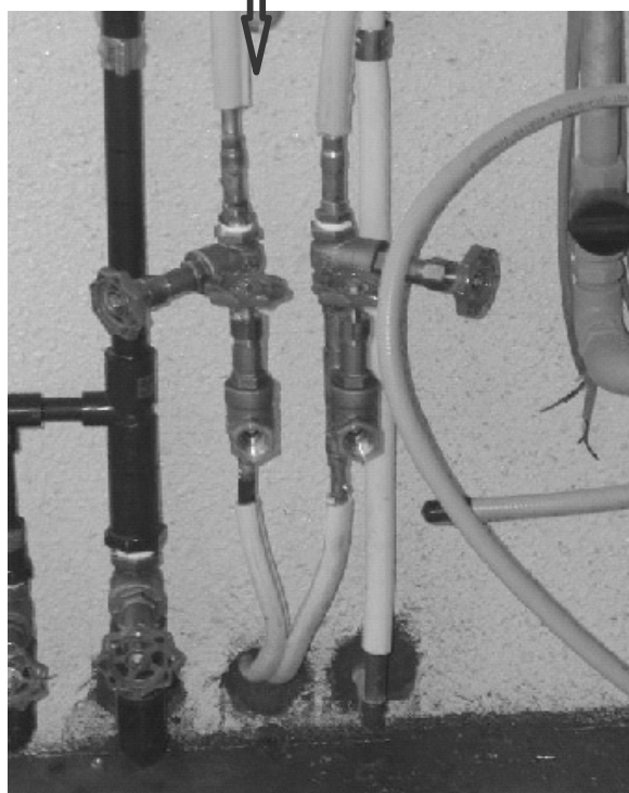
平成14年10月22日 潜熱回収型ガス給湯器(上) 他熱源接続用タッピング(下)
