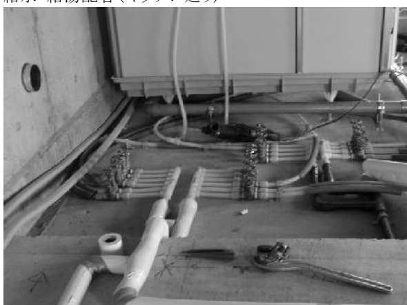
平成14年9月21日 給水・給湯ヘッダー
