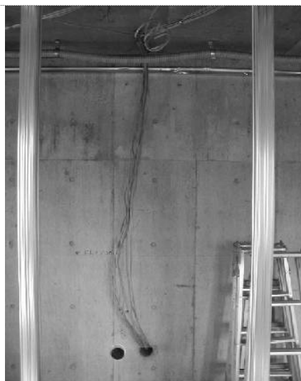
平成14年9月26日 電気配線(302からの引き込み)
