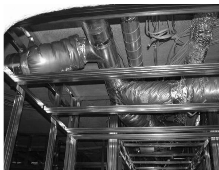
玄関上部天井内のダクト
