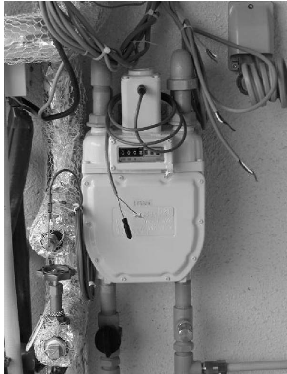
平成14年11月15日 パルス発信機付きガスメータ(301号室)
