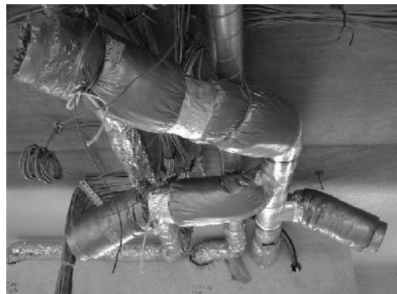
平成14年9月21日 ハイブリット換気 玄関上部のダクト
