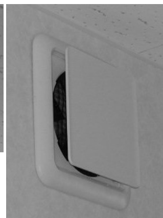
取り入れ外気吹出口(居室)
