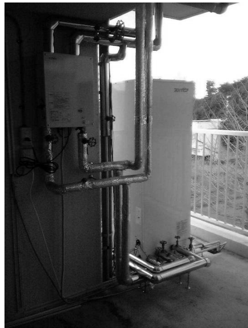
写真 8.4.4 自然循環型太陽熱温水器の混合ユニット（左）と強制循環太陽熱温水器貯湯槽（右）
