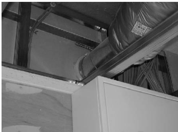
平成14年10月 9日 ハイブリッド換気ダクト貫通部のシール状況
