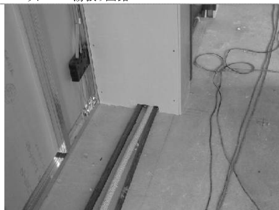
平成14年10月 3日 雨水利用系統配管
