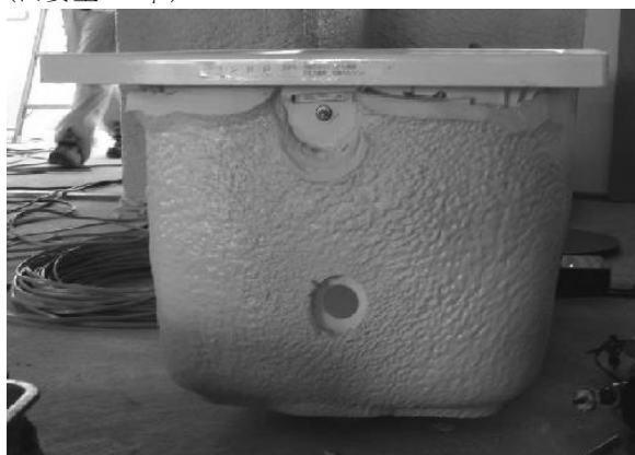
平成14年9月21日 ユニットバスの断熱状況(@35mm)
