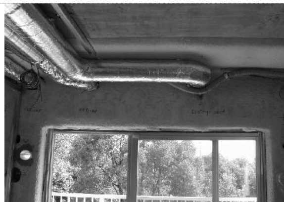
平成14年9月23日 レンジフードダクト
