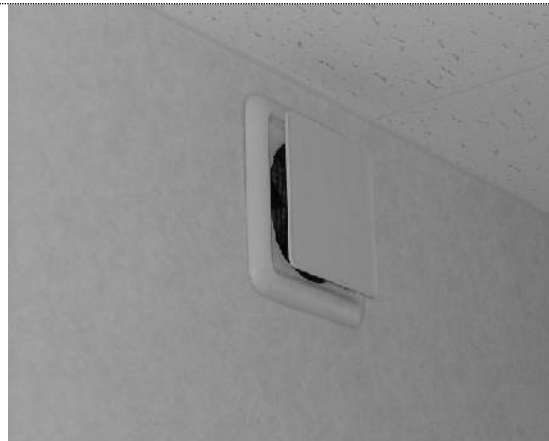
平成14年10月17日 ハイブリッド換気 子供室給排気口
