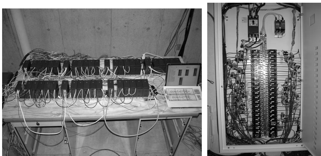
図 8.7.2 電力消費量測定器（左：電力測定ユニット 右：分電盤及びクランプ）
