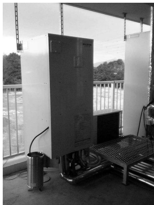
写真 8.4.5 CO 2 ヒートポンプ式給湯機の貯湯槽（左）とヒートポンプユニット（右）
