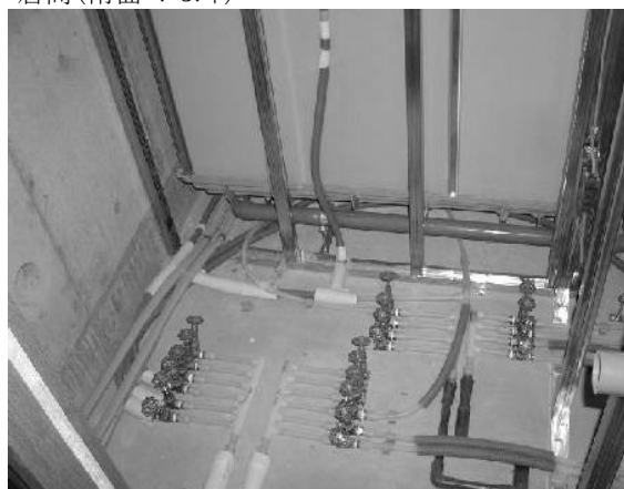
平成14年9月27日 ユニットバス 給水・給湯ヘッダー
