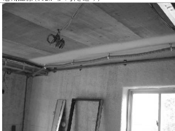
平成14年9月27日 全熱交換型換気装置 給気ダクト(居間)
