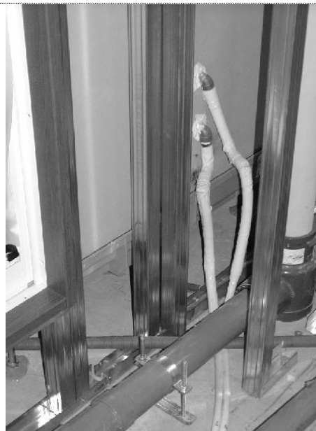
平成14年9月27日 ユニットバス 湯張り回路
