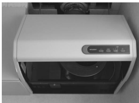
省エネ住戸（高効率モーター：消費電力25W）
