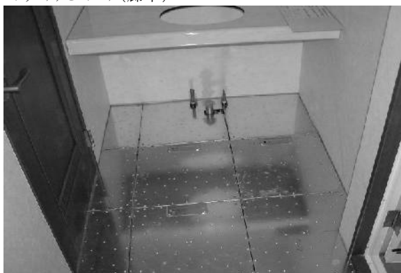
平成14年10月15日 フリーアクセスフロア(洗面)
