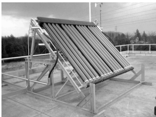
写真 8.4.2 自然循環型太陽熱温水器集熱部
