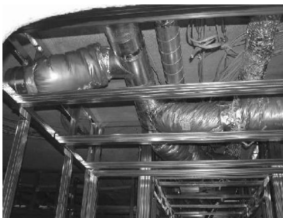
平成14年9月27日 ハイブリッド換気 玄関上部のダクト
