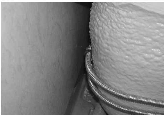
平成14年10月17日 ユニットバス注湯・追い炊き回路配管
