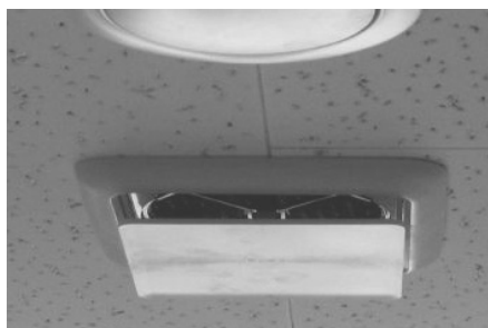
吸気口(廊下天井)
