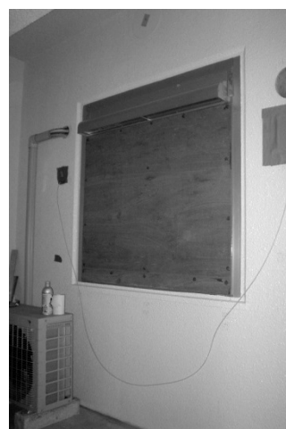
図 4.2.34 換気装置設置状況（現場実測のため既存開口部をつぶして換気装置のみ設置。）
