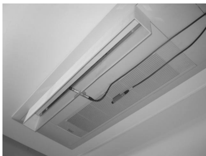
図 3.2.16 吹出・吸込気温の測定
