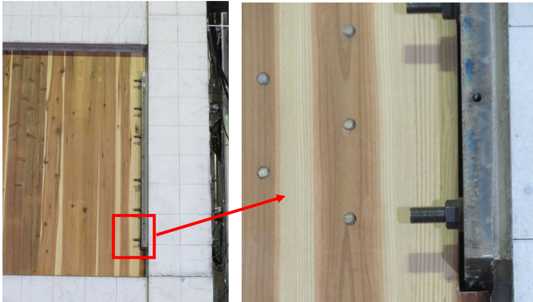
写真 2-38 2F の鉛直接合部における鉄板-CLT 耐力壁間の離間 (R=1/133)
