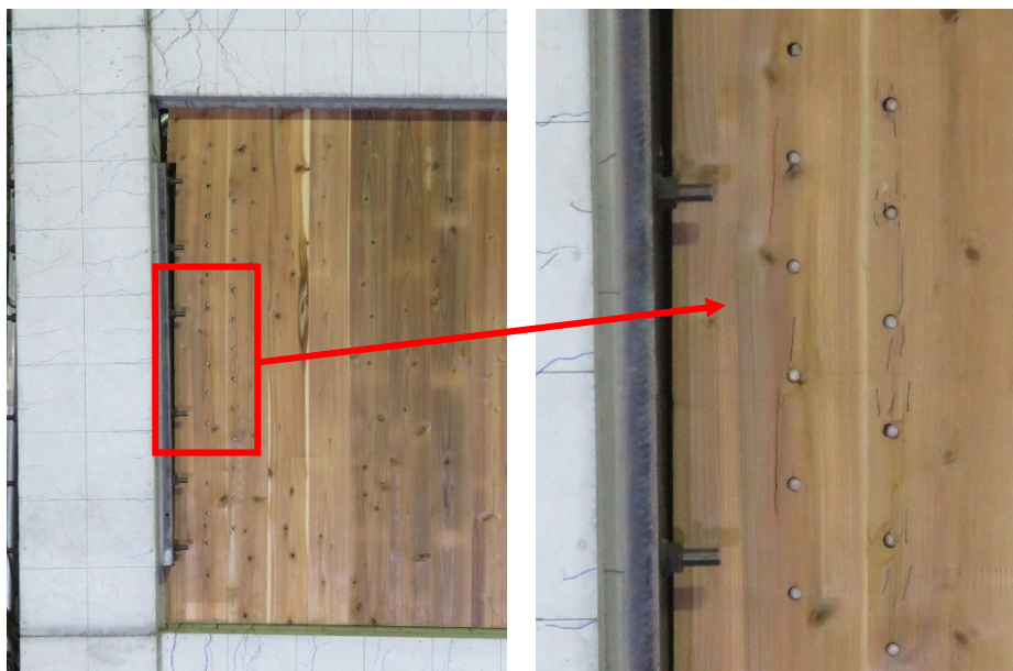
写真 2-41 2F の鉛直接合部における鉄板-CLT 耐力壁間の離間とラミナの亀裂 (R=1/50)
