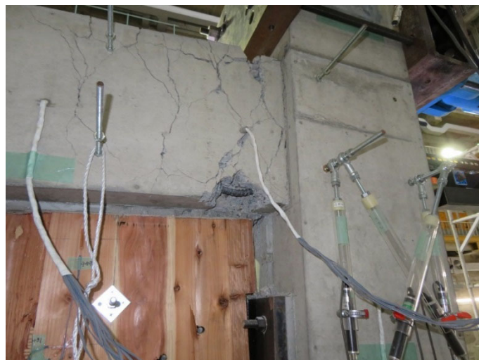
写真 2-42 3F はりにおけるコンクリートの剥落 (R=1/33)
