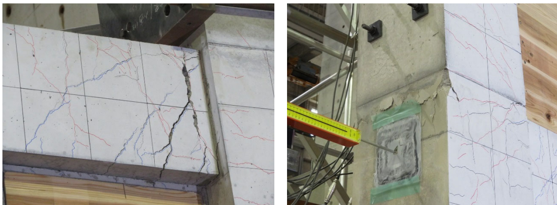
写真 2-29 3F はり、2F 柱はり接合部におけるコンクリートの剥落 (R=1/50)
