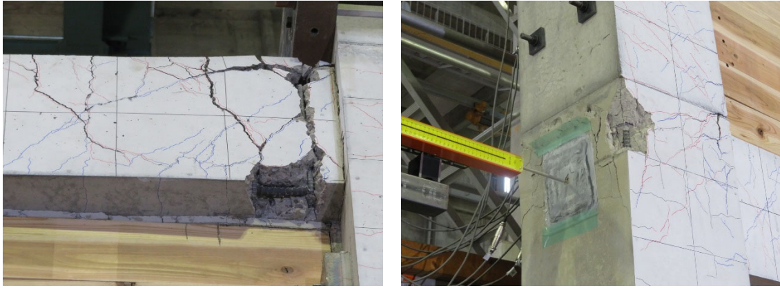
写真 2-32 3F はり、2F 柱はり接合部における主筋の露出 (R=1/33)
