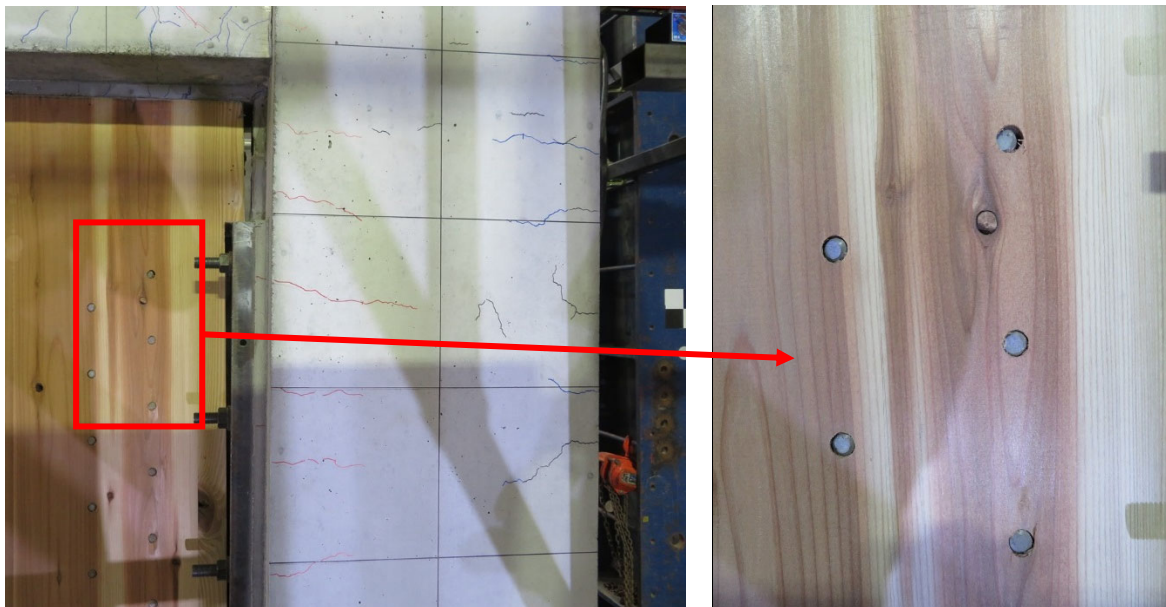
写真 2-39 2F の鉛直接合部における鉄板-CLT 耐力壁間の離間 (R=1/100)
