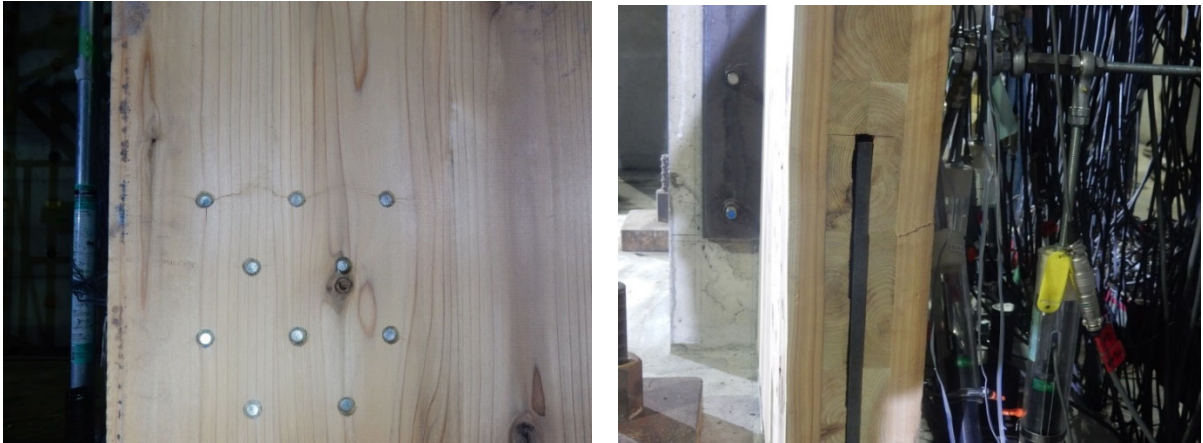
写真3-19 ドリフトピン接合部の圧縮しわ (R=1/50)
