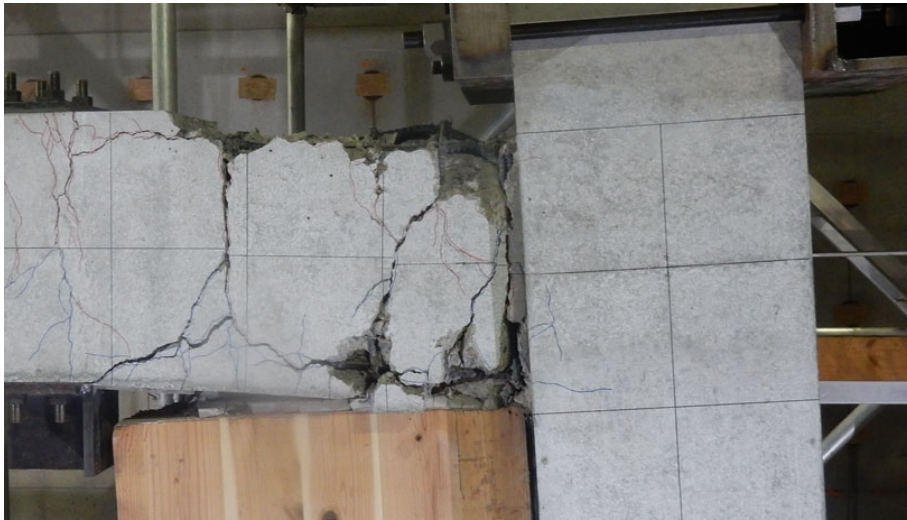
写真 3-30 RC はり主筋の座屈 (R=1/25)
