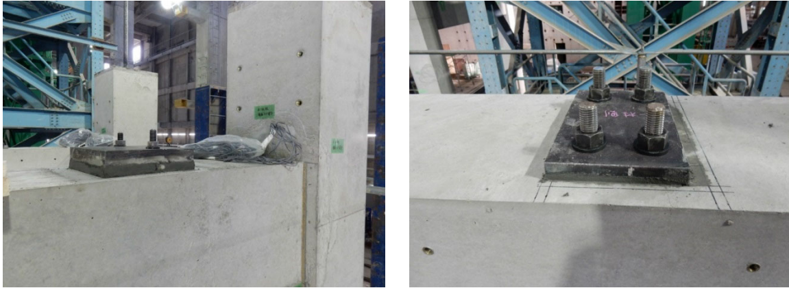
写真 3-5 3 階はり上の水平目地のモルタル充填状況
