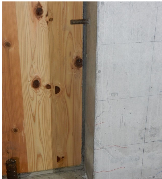
写真 3-27 鉛直目地における離間 (R=1/200)
