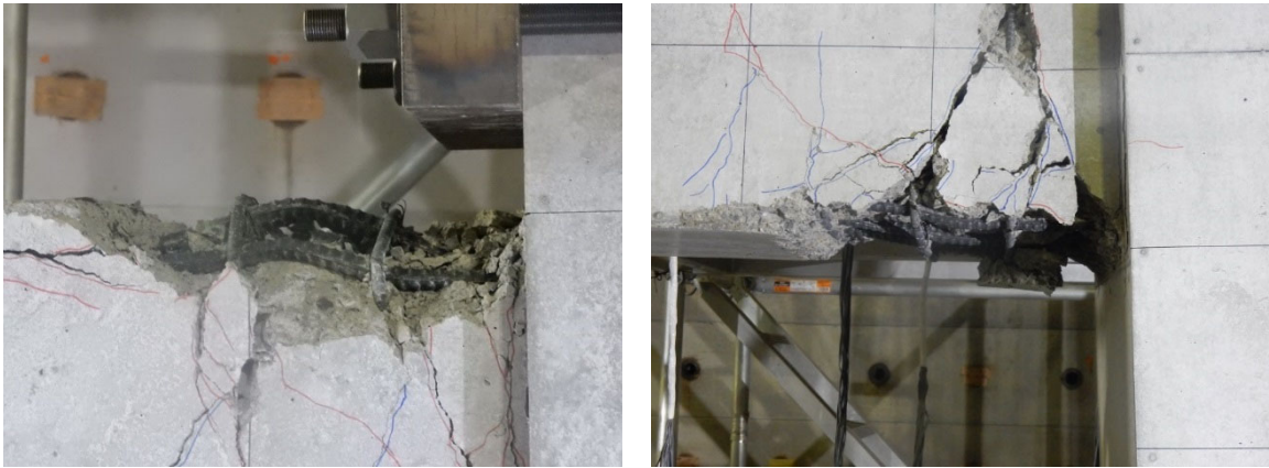
写真 3-36 RC はり主筋の座屈 (R=1/25)
