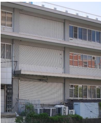
写真7 増設耐震壁側柱のせん断破壊
