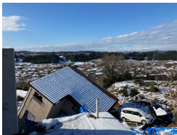
写真 4.1 崩壊した斜面の状況 (1)
