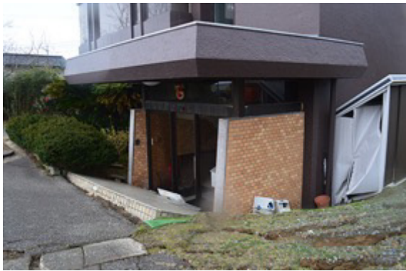
写真 5.4 正面入口付近の状況（沈下）
