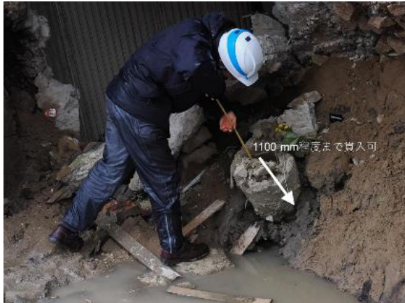
写真 6.5 露出した杭頭
