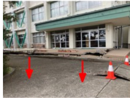
f) 周辺地盤が沈下した建物
