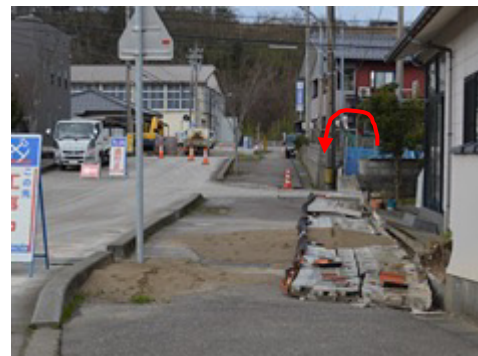
j) 擁壁の転倒
