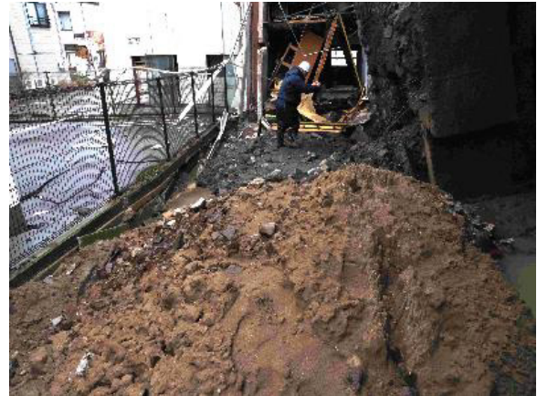
写真 6.6 地表面の変状 (敷地の南側)
