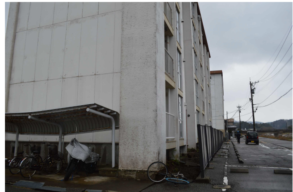
写真 9.2 周辺地盤の沈下による駐輪場ポートの被害
