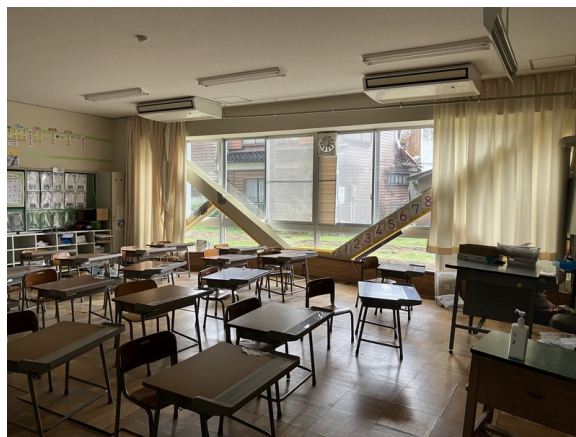
写真 8.2 1 階での床の盛り上がり
