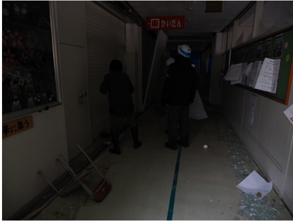
写真 8.3 建物内部のガラスの散乱状況
