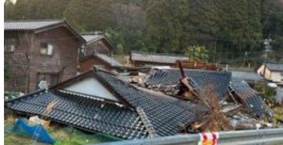
写真 6.4.2 穴水町鹿島の倒壊家屋群
