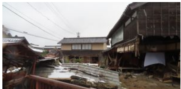
写真 6.6.6 津波により倒壊した木造住宅
