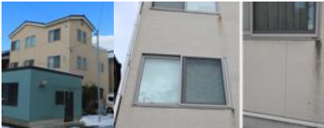
写真 6.9.1 珠洲市野々江町の 3 階建枠組壁工法住宅の開口周囲のひび割れ (2004 年竣工)
