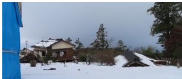
写真 6.3.24 1層が崩壊した木造住宅と倉庫
