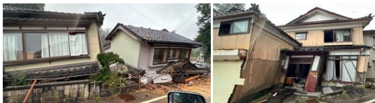
写真 6.3.2 珠洲市役所前以外で倒壊を含む大きな被害を受けた家屋（珠洲市上戸町）
