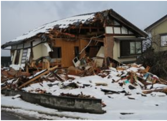
写真 6.3.19 倒壊した木造住宅
