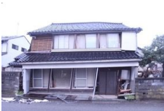
写真 6.7.9 大きく傾斜した木造住宅
