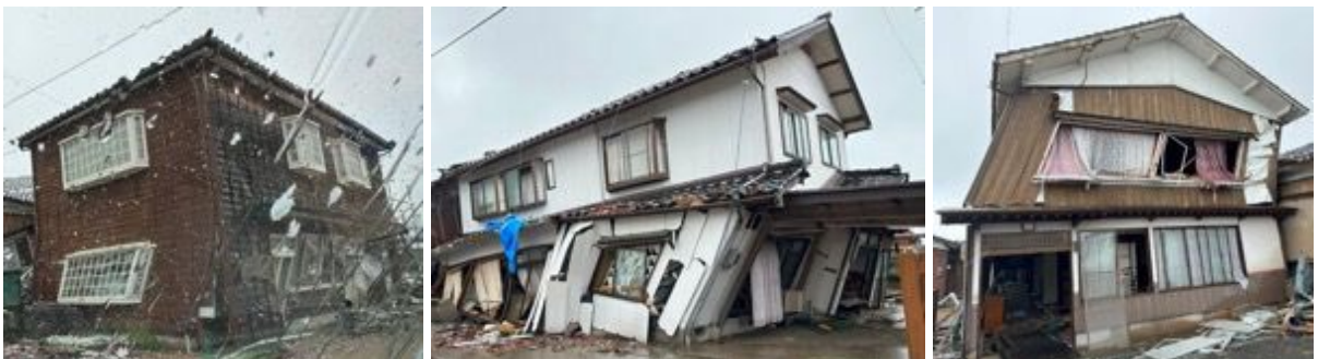
写真 6.3.10 安全限界変形を超える残留変形がある家屋（珠洲市宝立町鵜飼）
