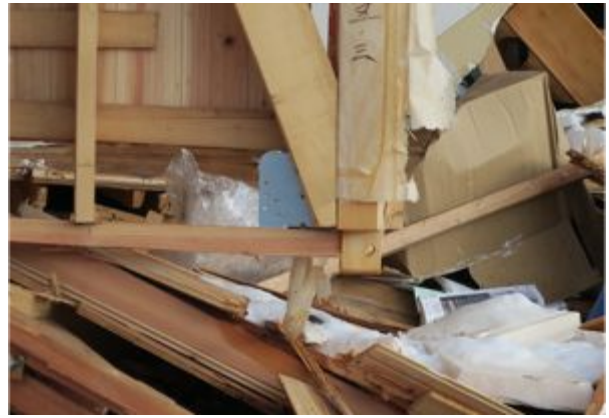
写真 6.3.20 写真 6.3.19 の筋かい端部の金物
