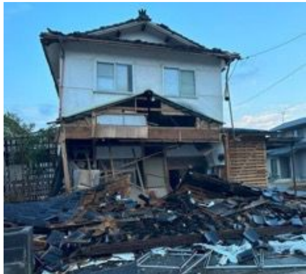
写真 6.4.6 傾斜が残る住宅(穴水町川島)
