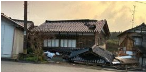
写真 6.4.3 穴水町曾福の倒壊家屋
