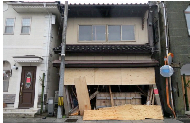
写真 6.7.8 大きく傾斜した木造店舗併用住宅
