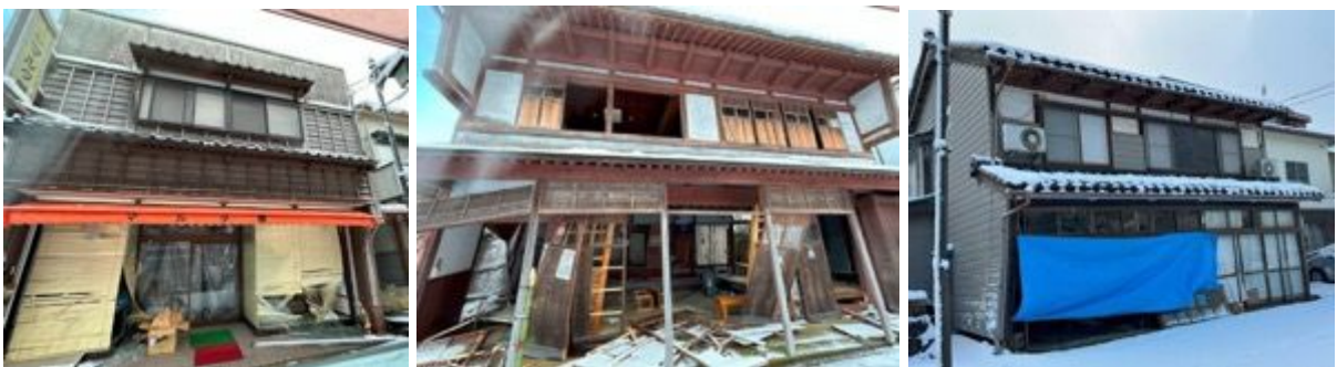
写真 6.2.2 一部は安全限界変形を超える大きな残留変形のある家屋（門前町門前）
