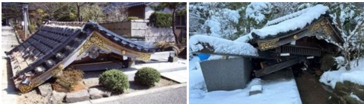
写真 6.2.7 2007 年地震時の倒壊（左：'07 年撮影）後に再建された手水処の倒壊
