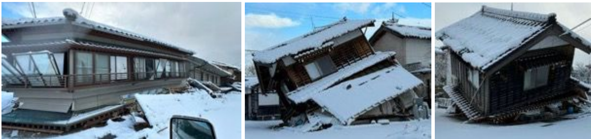
写真 6.2.1 門前町門前・走出の倒壊家屋群
