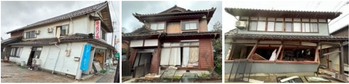
写真 6.3.7 珠洲市正院町正院で一部は安全限界変形を超える大きな残留変形が残る家屋
