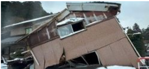
写真 6.5.2 倒壊した納屋
