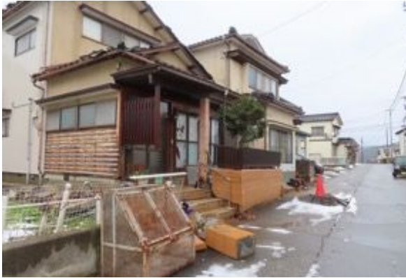
写真 6.6.1 外壁が剥落した木造住宅
