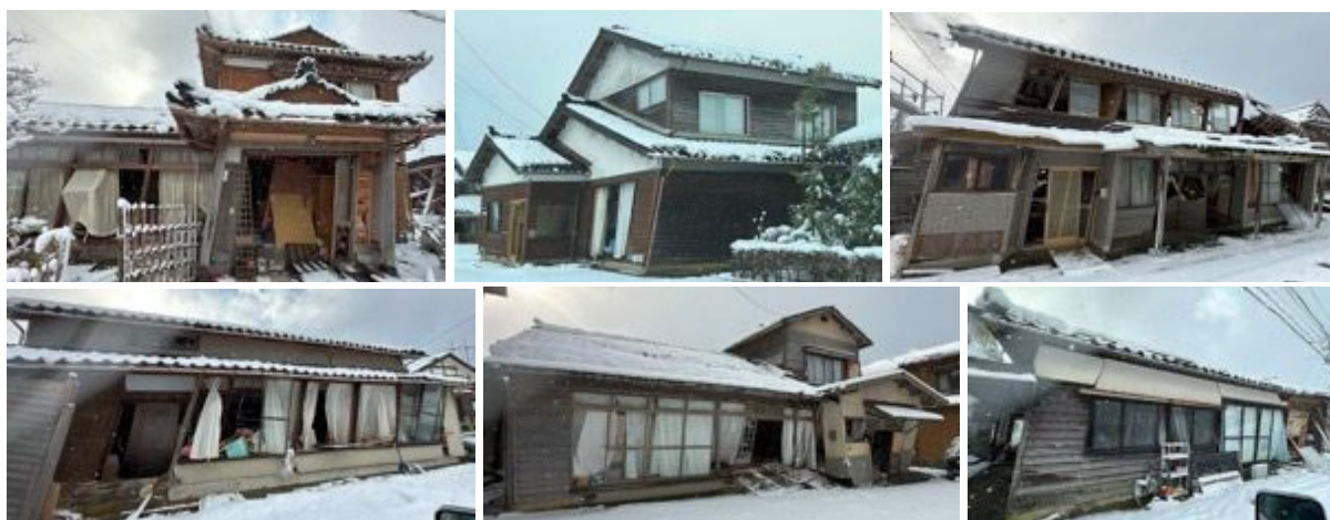
写真 6.2.9 一部は安全限界変形を超えるような大きな残留変形がある家屋（門前町道下・館）
