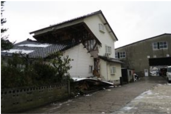
写真 6.4.13 1層が崩壊した3階建て木造住宅
