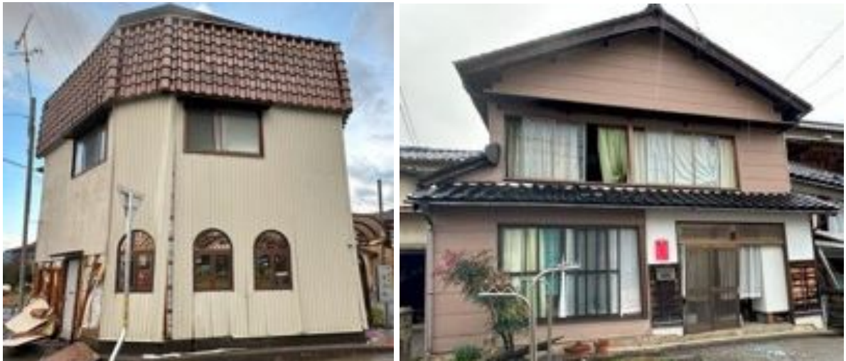
写真 6.4.8 残留変形がある家屋（穴水町大町）
