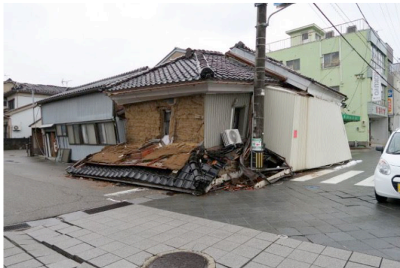
写真 6.7.7 倒壊した木造住宅
