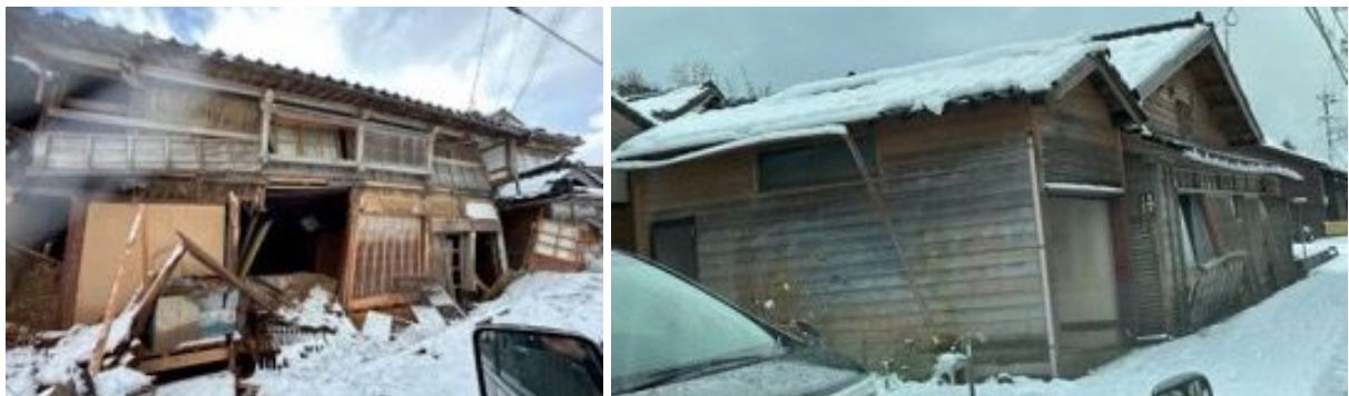
写真 6.2.14 一部は安全限界変形を超えるような大きな残留変形がある家屋（門前町黒島）
