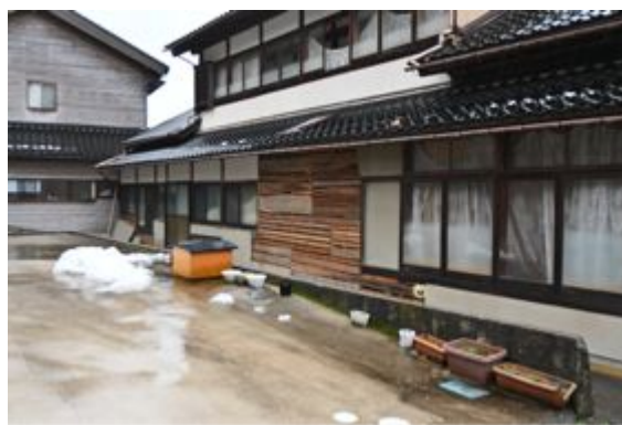
写真 6.7.2 外壁の剥落した木造住宅
