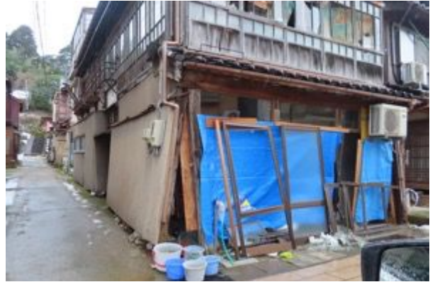
写真 6.6.2 大きく傾斜した木造店舗併用住宅
