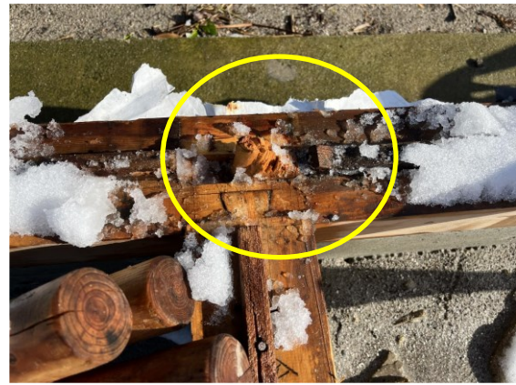
図 6.3.11 流失した住宅の土台の状況(2)
