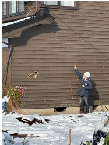
図 6.2.11 津波の漂流物の痕跡
