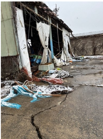
図 5.2.1 鉄骨造倉庫の被害
