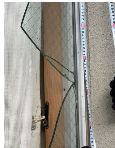
図 6.1.6 損傷した窓ガラスの高さ
