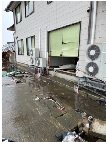
図 5.2.2 木造建築物の被害
