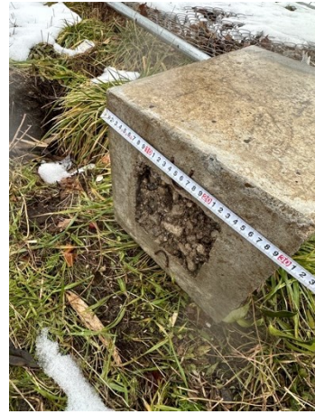
図 4.1.3 フェンスの引き抜けた基礎
