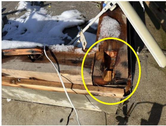
図 6.3.10 流失した住宅の土台の状況(1)
