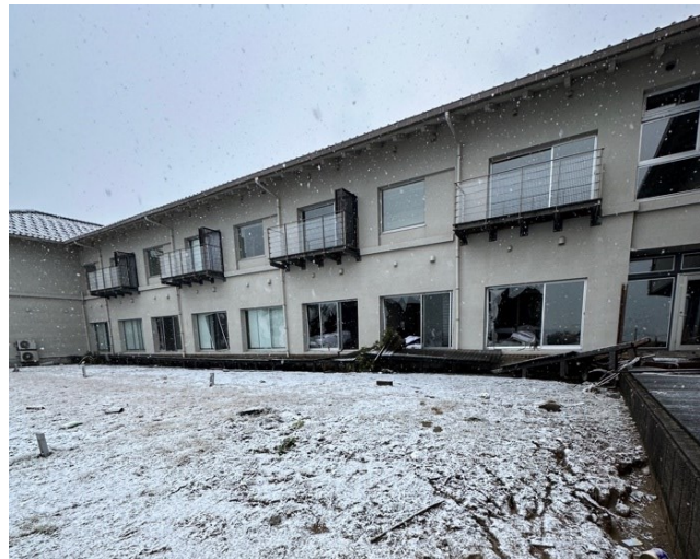
図 5.1.2 1階の窓ガラスの損傷(1)
