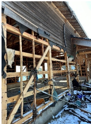
図 6.3.5 陸側の外壁の損傷
