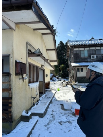
図 6.3.13 外壁の損傷と津波の痕跡の測量
