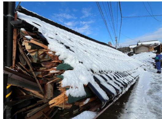
図 6.2.17 倒壊した建築物の瓦屋根
