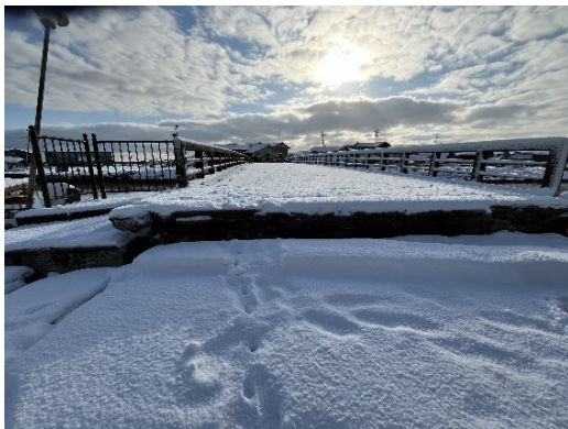
図 6.2.16 橋と道路との間の段差
