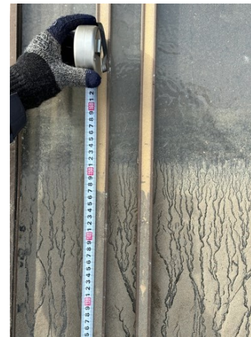
図 6.2.14 玄関に付着した痕跡
