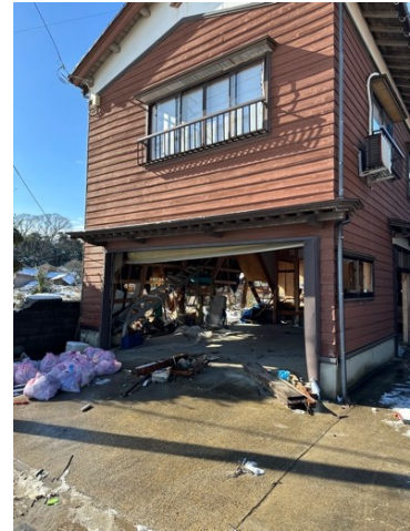
図 6.3.3 津波による開口部の損傷
