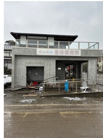
図 5.5.5 RC 造の建築物の被害状況(1)
