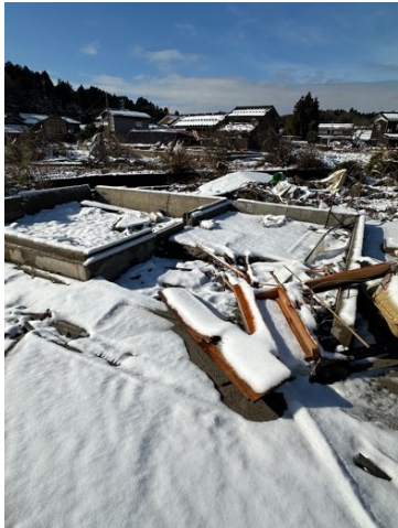
図 6.3.1 流失した住宅(1)
