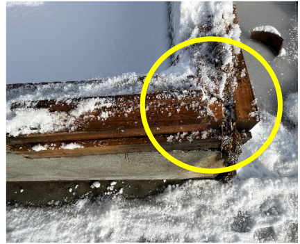
図 6.2.5 流失した住宅の土台隅角部の状況
