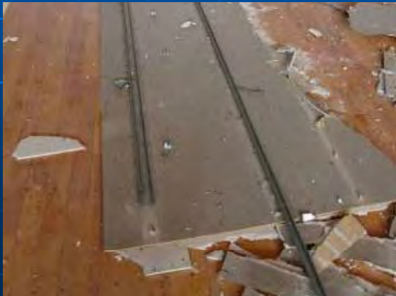
床面に落下した天井(クリップの外れ)
