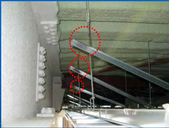
斜め部材の溶接の外れ
