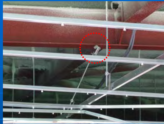
H形鋼梁への吊り金具の外れ
