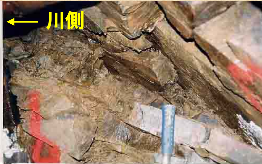
クリープにより、川側に傾斜し た割れ目
