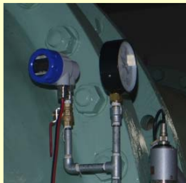
ポンプ吐出圧力脈動
