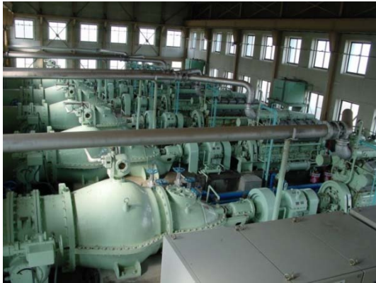
排水ポンプ設備
