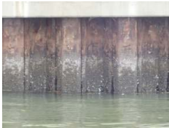
汚れや貝類の付着等により、腐食の判別はし難い。 板厚方向への腐食の進行は、目視では把握できない。
