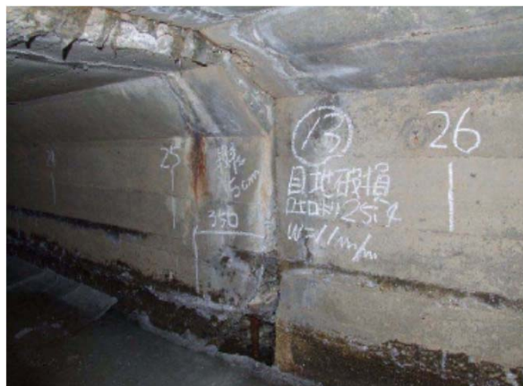
目地の部分で大きな段差(不同沈下)
