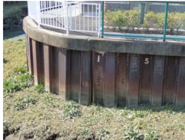
傾きによるジョイント部の開き
