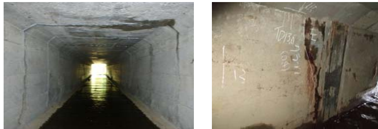
乾燥収縮、温度変化による損傷例(①)
