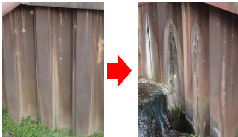
ジョイント部(漏水による腐食)
