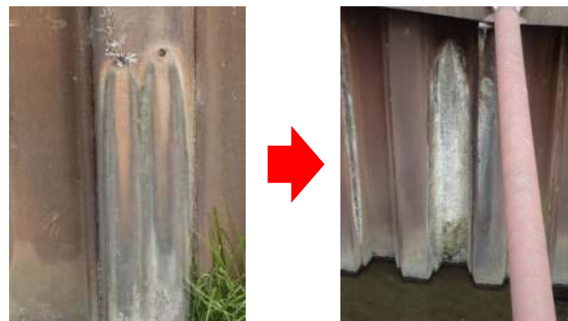
開孔部の下部(漏水による腐食)
