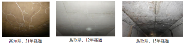
写真6.1 ⑥頂版函軸方向・不規則網目状ひび割れの例 (チョークによる強調あり)
