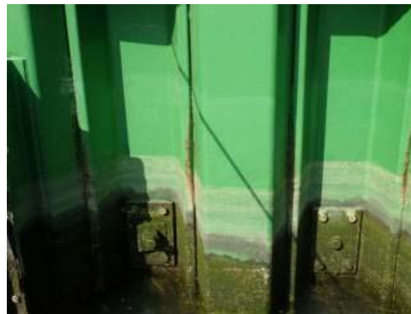
ジョイント部(干満部の隙間腐食)
