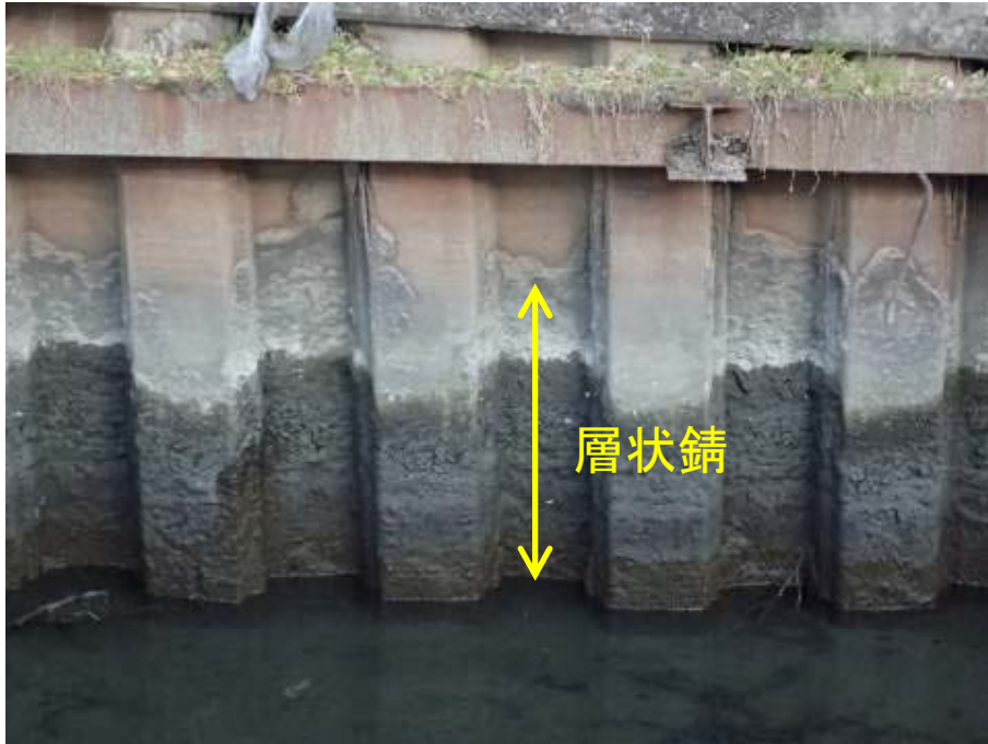
水際付近から成長した層状錆
