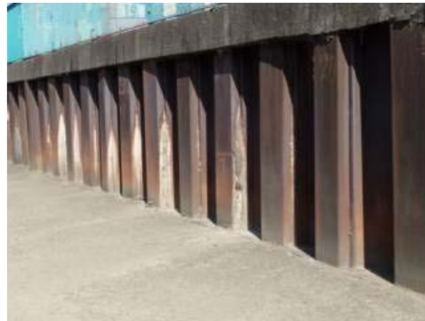
ジョイントからの漏水による腐食
