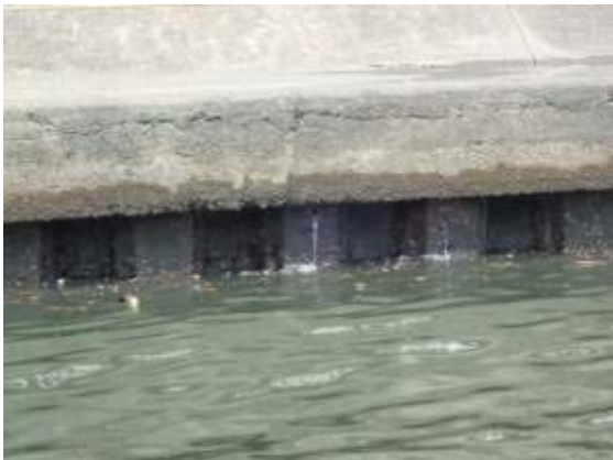
コンクリートの剥落・割れや、矢板の漏水のような大きな変状は把握することができる
