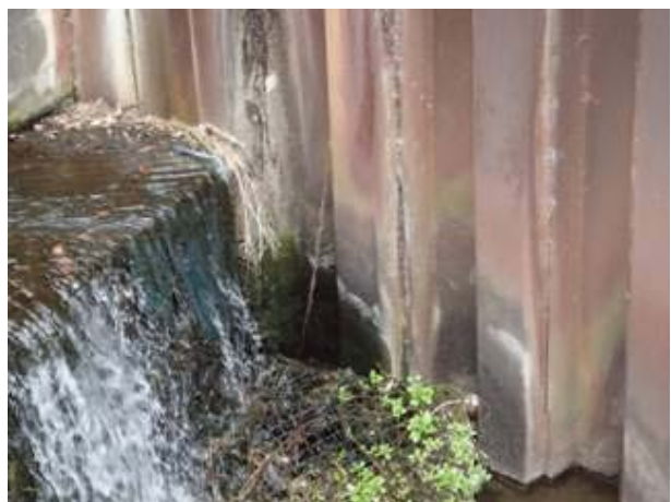
落差工付近(飛沫による腐食)
