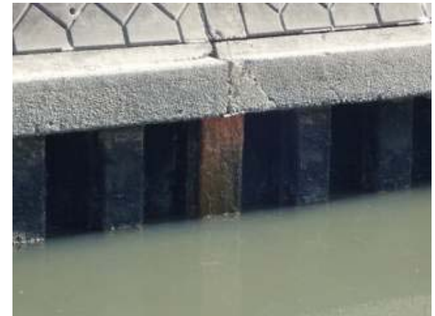
笠コンクリート目地部からの漏水による腐食
