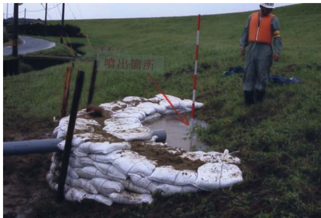
函体下の空洞に係る漏水
