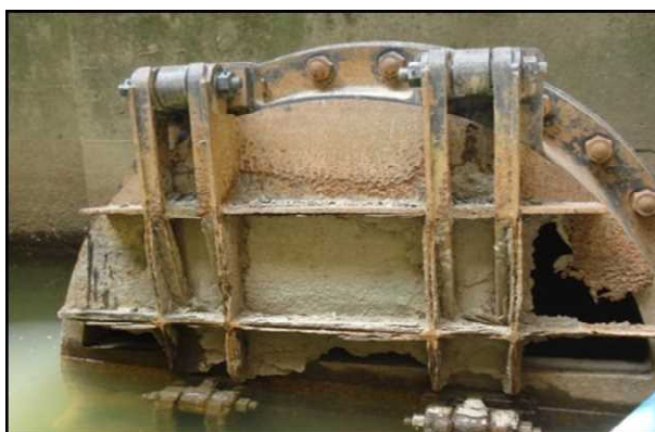
ポンプ設備(逆流防止弁)の損壊状況
