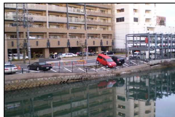
護岸の損壊状況
