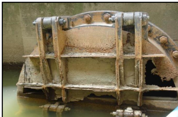
ポンプ設備(逆流防止弁)の損壊状況
