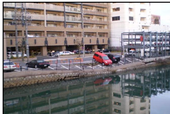
護岸の損壊状況
