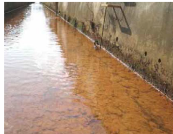
水路底に堆積した鉄バクテリア集積物
