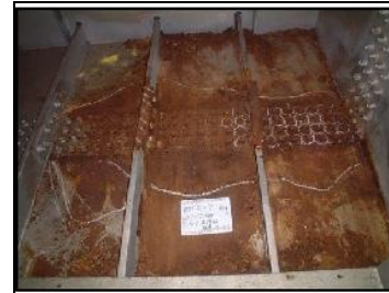
西大阪 S-7 鋼本体さび・腐食 A 点検年度：2004
