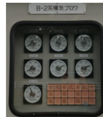
写真2 ブロワ操作盤
