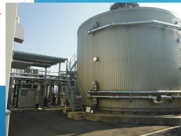
無動力攪拌式消化タンク
