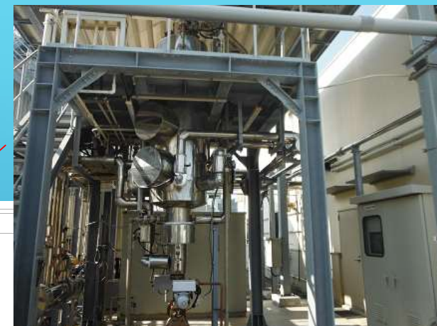
高効率加温設備 (可溶化装置)
