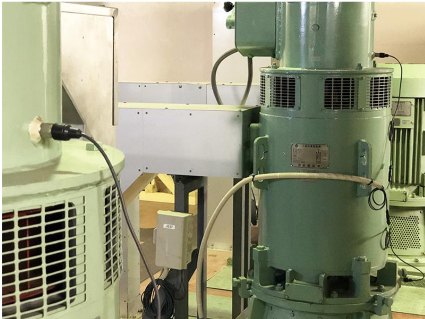
振動センサ取り付け状況（污水主ポンプ）
