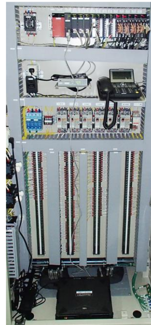
監視盤内全景
