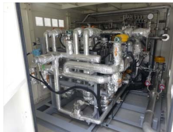
ガス分離膜装置
