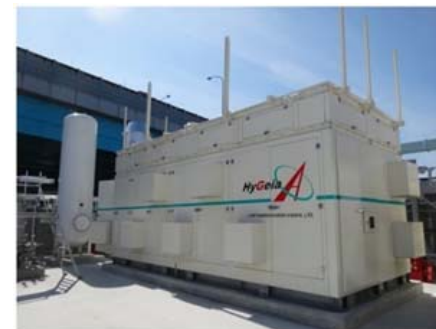
水素製造設備
