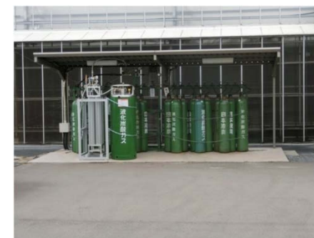
液化CO 2 タンク
