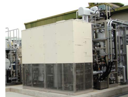
CO 2 液化回収設備
