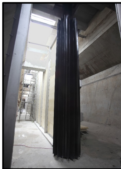
二点DO制御技術 水流発生装置
