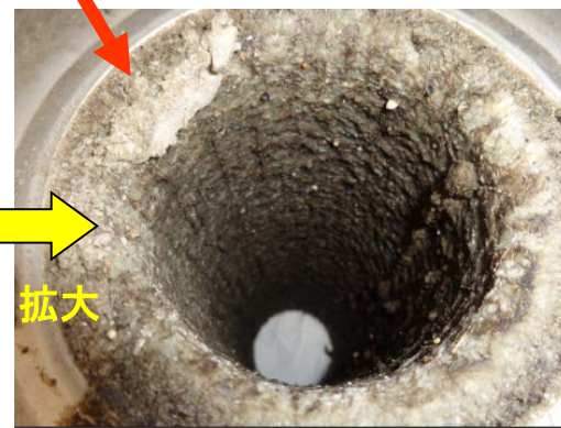
リン除去・回収バイパス 運転時使用配管
