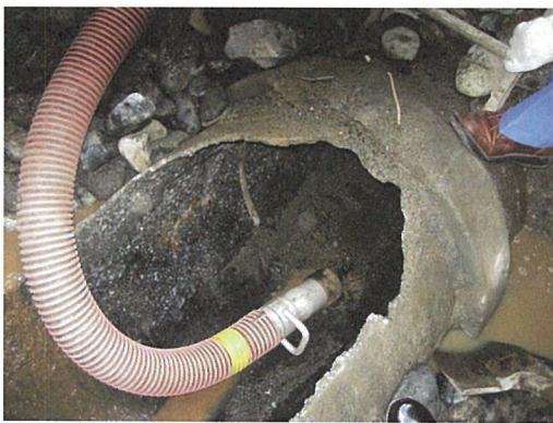
写真一 硫化水素が原因の下水管破損事例
