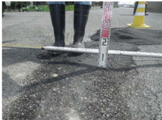
写真-1 マンホール部人孔浮上状況（災害査定資料より）
