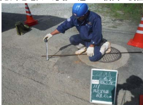
写真-2 マンホール部人孔浮上状況（災害査定資料より）
