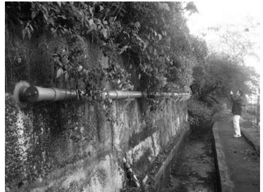
写真-1 クイック配管
