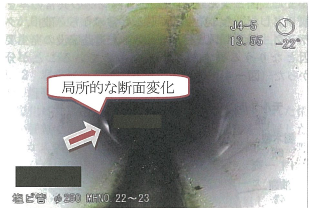
写真-3 変形の事例
