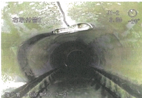
写真-1 破損の事例
