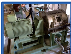
汚泥可溶化設備
