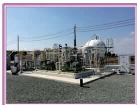
CO 2 分離・回収(CCU)設備
