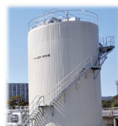
③担体式高温消化槽
