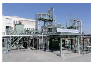
実証設備の外観
