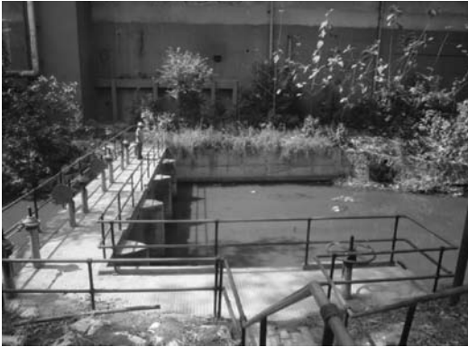
写真－3 流入水は汚濁した排水路より
