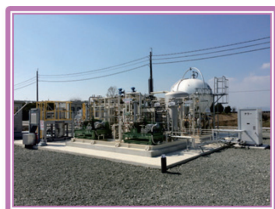
CO 2 分離・回収（CCU）設備
