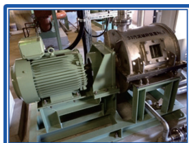
汚泥可溶化設備
