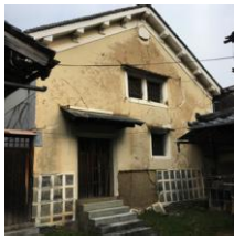
傷みの進む歴史的建造物
