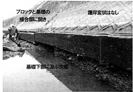
写真-1 護岸基礎部の局所洗掘の状況（H23.1調査）
