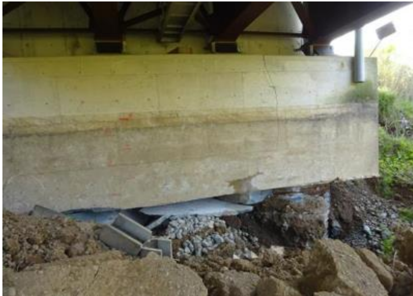
沈下した 橋台
