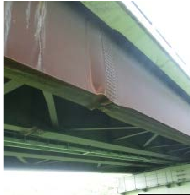
橋の主桁に 生じた変形
