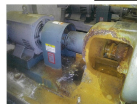
空調用冷温水ポンプの腐食 [水質水文共同実験棟]
