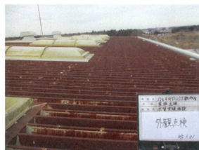
折板屋根の発錆・劣化 [水質実験施設]
