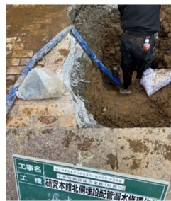
埋設配管からの漏水 [研究本館前庭]
