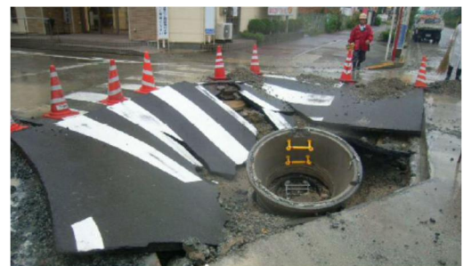
図 1 マンホールの被災事例
