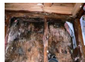
含水率が高くなり腐朽した外壁内部(築6年)
