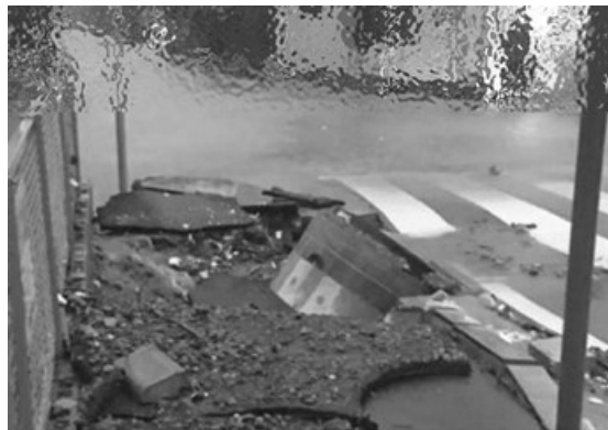
写真 1 大雨による下水道管路の被災例 （マンホールの破損）
