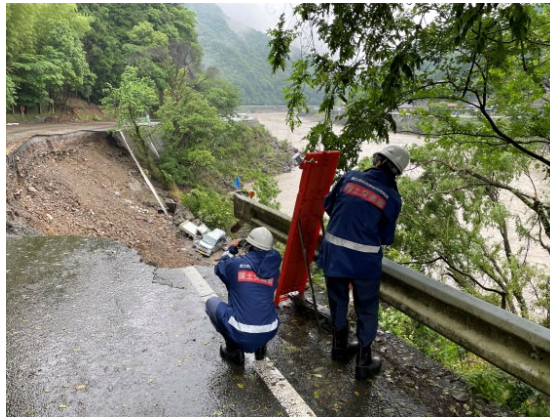
写真-5.5 球磨川沿いの道路の路肩崩壊箇所の現地調査 (R3. 5. 21)
