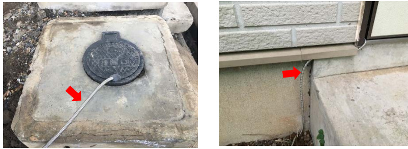
資図 2-22 地上部の光ファイバークーブル露出区間の養生状況 (ステンレス製ケーブルガードを使用)
