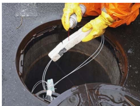
資図 2-27 冷却スプレーを利用したケーブル位置評定の実施状況
