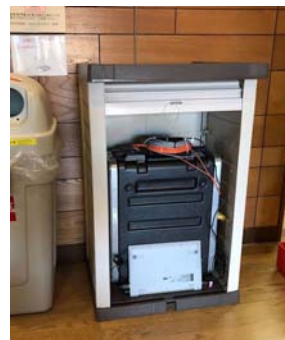
DTS の設置状況 (F37 ブロック)
