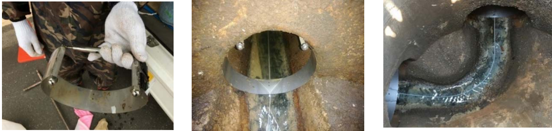
資図 2-18 固定マウントによる光ファイバーケーブル固定状況（スチールバンドを使用）
