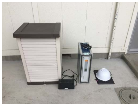
設置機材の外観（格納コンテナ、ノート PC、 DTS、無線 LAN アンテナ）
