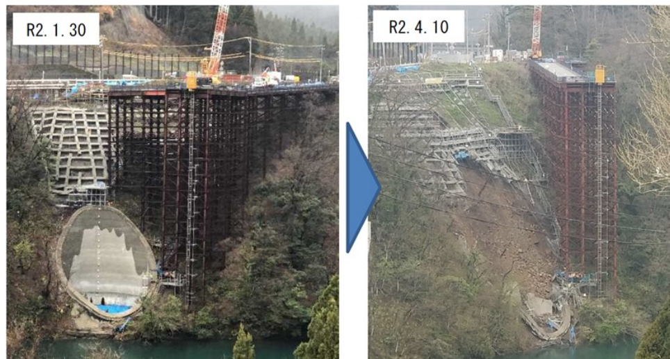
竹割り工崩壊の状況
