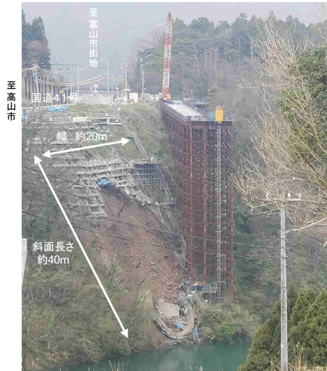
のり面崩落の状況
