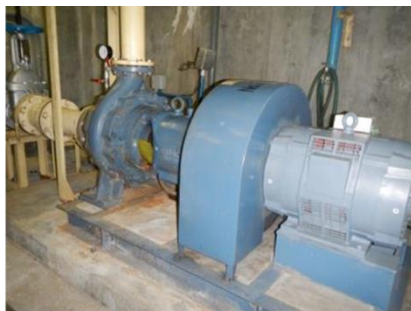
国見第一ポンプ場 No2ポンプ 形式：横軸スクリーウポンプ 仕様：150mm×1.32m 3 /min 電動機出力：22kW-200V センサー番号：234 センサー設置期間：2015/9/7～2019/4/9 (3年7ヶ月) 設置環境：換気設備あり、湿度未測定(ジメジメ感なし) : 室温26℃ (2019/8/29)、結露なし
