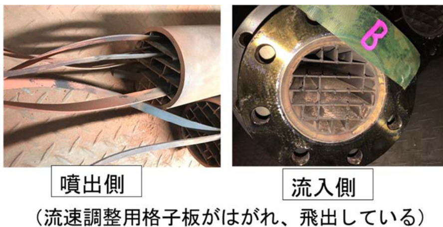
図資 1.3.6-2 流速調整用格子板損傷状況
