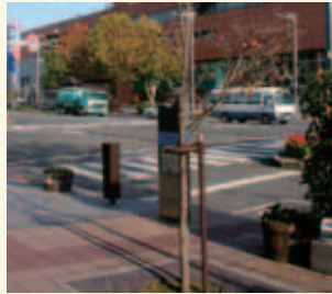
鋼製支柱の破損
