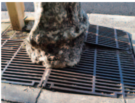
（踏圧防止板の樹体への食い込み）
