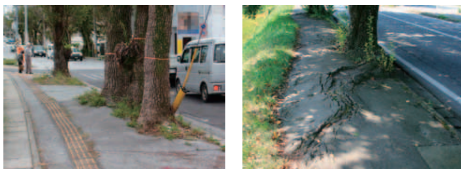
写真-3.21 根上りによる通行障害
