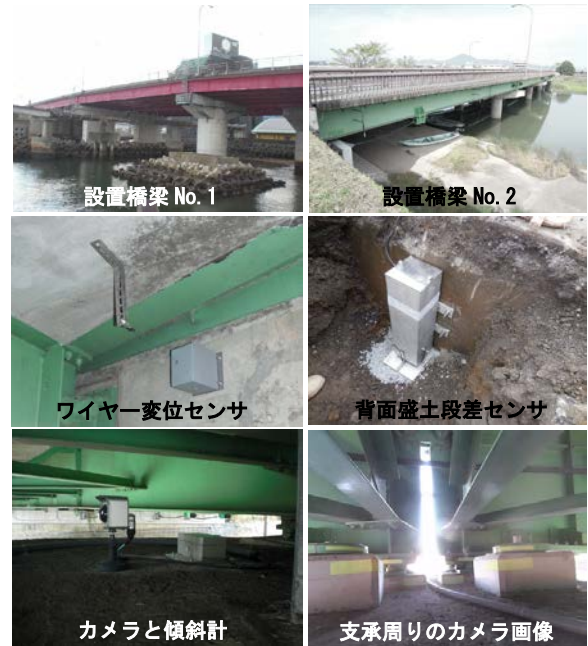
図-4 道路橋被災状況把握システムの設置状況
