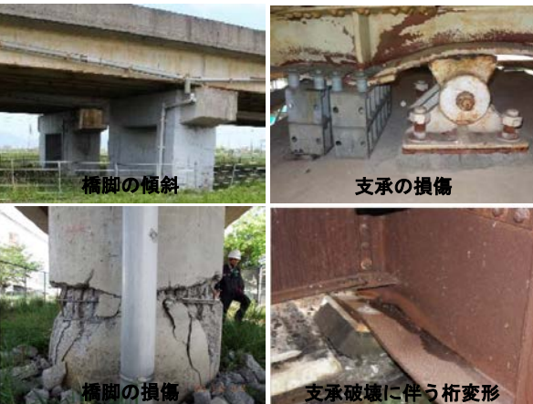
図-2 熊本地震における道路橋の特徴的な被害 (H28.6.24 第5回道路技術小委員会配布資料より引用)
