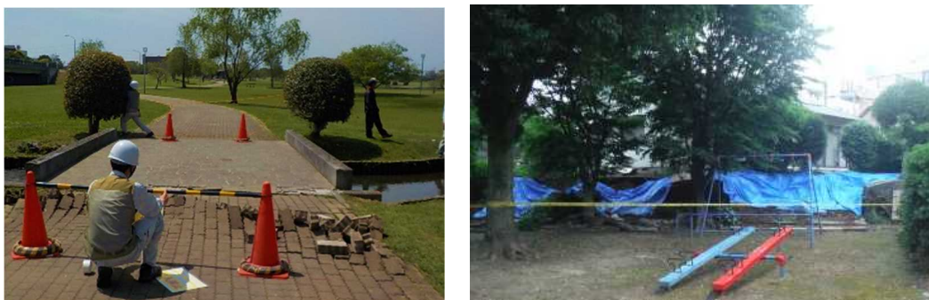
図Ⅳ－3 公園施設の被害調査及び応急措置（使用・立入禁止）の実施例（熊本市）
